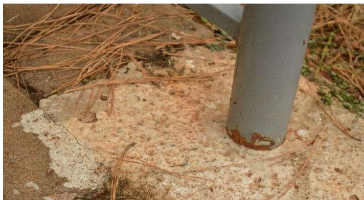
Figura 15: Outro ângulo do guarda-corpo, localizado ao lado do ginásio de esportes, o qual apresenta focos de oxidação. Isso revela o tipo de aço utilizado como sendo carbono.
