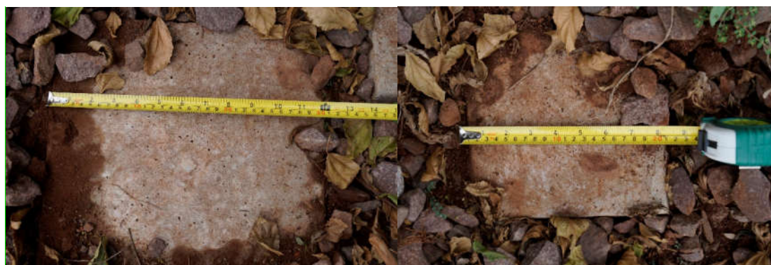
Figura 22: Caixas de passagem em alvenaria.
